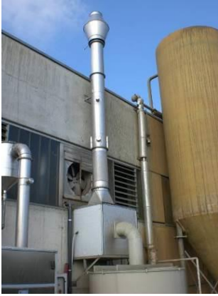
Figura 34 Camino impianto di deodorizzazione
