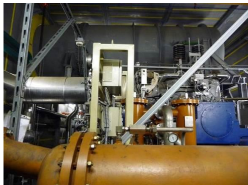
Figura 12 Particolare della sala turbina
