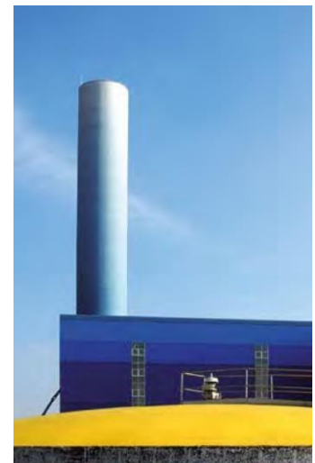
Figura 29 Particolare del punto di emissione E4/a
